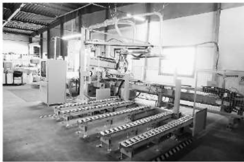
稼働したSDPCライン
